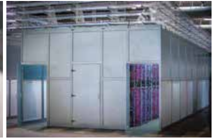
Figure 3 : Containers remplis de racks et de serveurs – Source : OVH.
