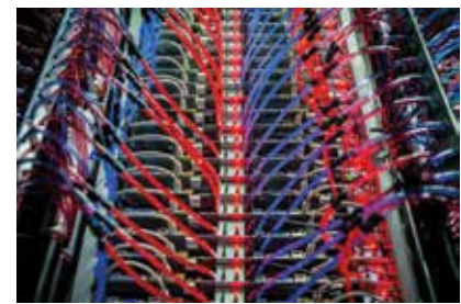
Figure 4 : Racks refroidis par eau à Gravelines. Source : OVH.
