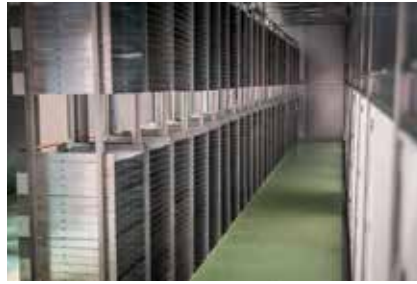
Figure 2 : Racks à l'intérieur d'un container prêts à accueillir les serveurs – Source : OVH.
